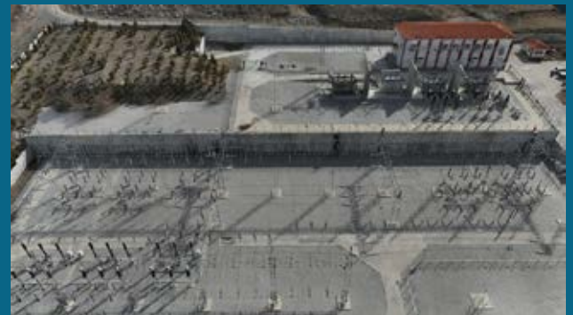
Resim 1: Transformatör merkezi genel görünüm
