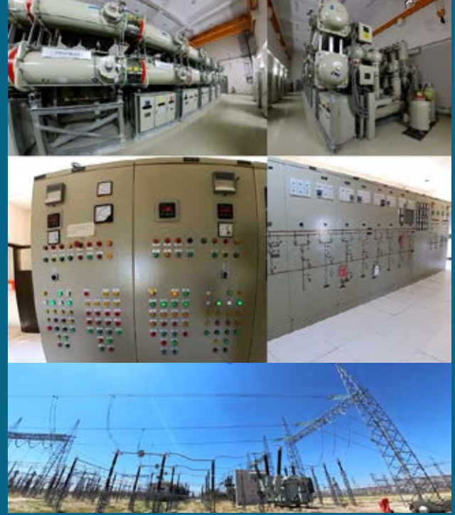
Resim 3: Transformatör merkezi 360 derece kamera ile çekilmiş video görüntüleri
